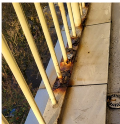
Corrosion à la base du garde corps
