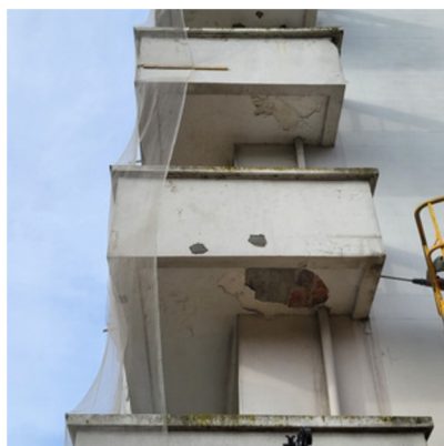
Ecaillage de peinture dû à des infiltrations
