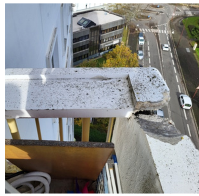
Sinistre dû à une surcharge
