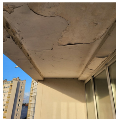
Ecaillage de peinture dû à un environnement salin
